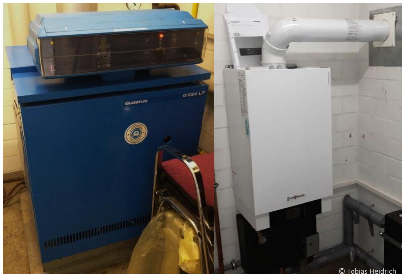
60 kW-Niedertemperaturkessel Bj. 1995 vs. 55 kW-Gasbrennwerttherme Bj. 2016
