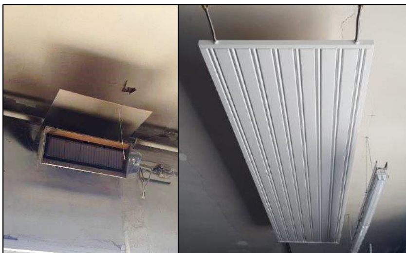
Alte Gasdirektstrahler (links) vs. energieeffiziente Infrarot-Deckenstrahlplatten.
