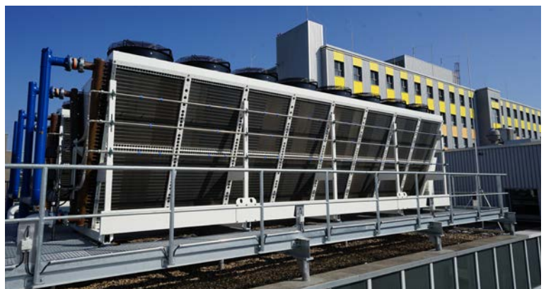
Klinikum Magdeburg – 10 kW Rückkühler
