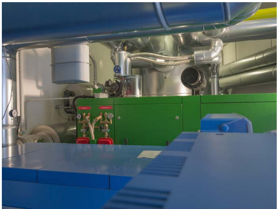
KWK-Anlage in einem technischen Betriebsraum
