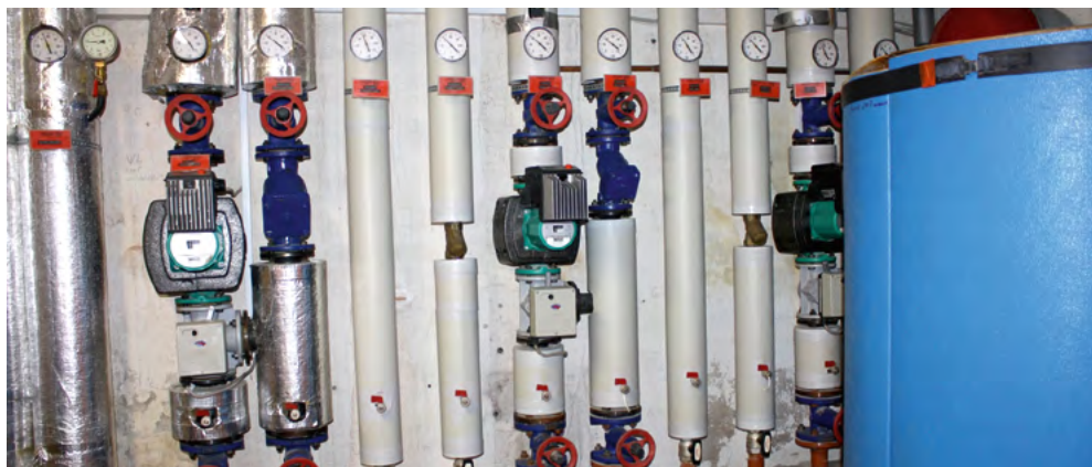
Foto: gedämmte Heizungsrohre, Florian Kliche
